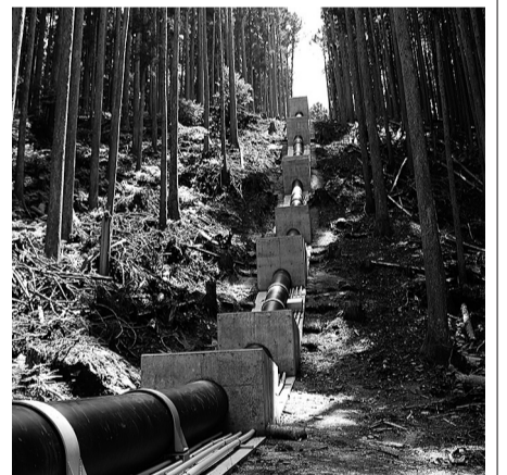
管を通じて水が急斜面を流れ水車を回す馬野川小水力発電所の「導水管」
